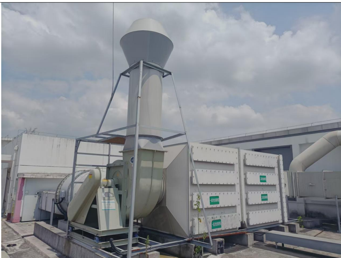
二级活性装置+27m 高排气筒 FQ4
