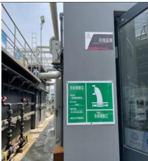
污水排口及标识牌
