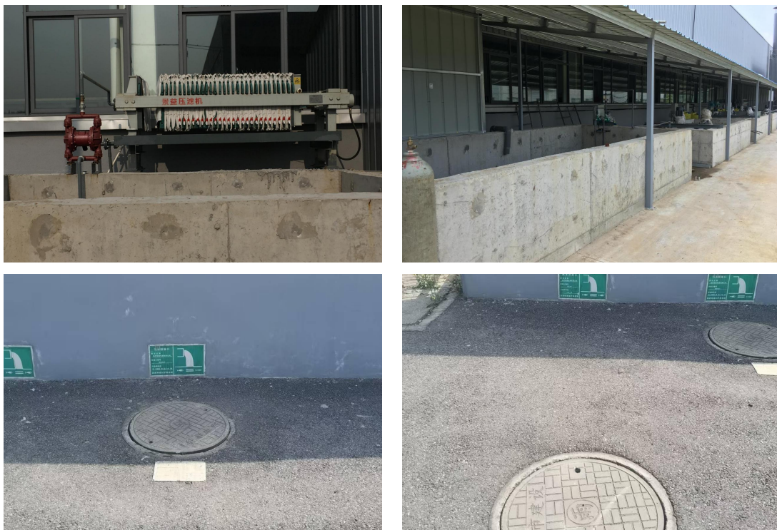
图 3-5 废水处理装置及污水污水分设排口
