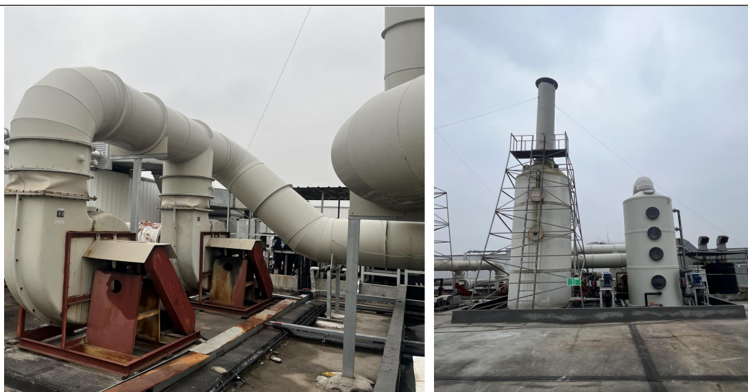
二级喷淋碱液氧化+排气筒 DA003
