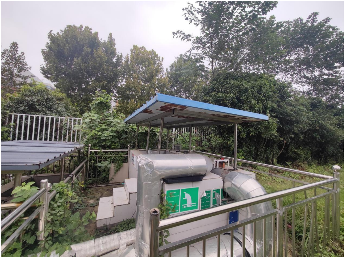
图 3-2 污水总排口及标识牌
