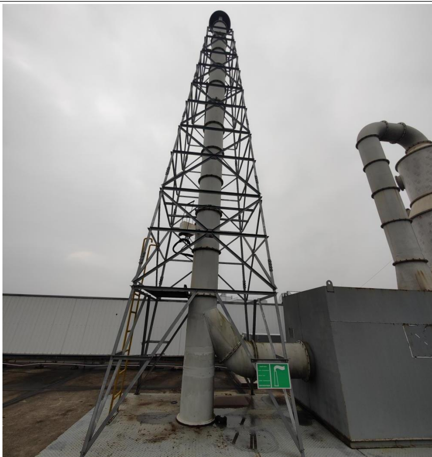
图 3-3 废气处理装置及排气筒标识标牌
