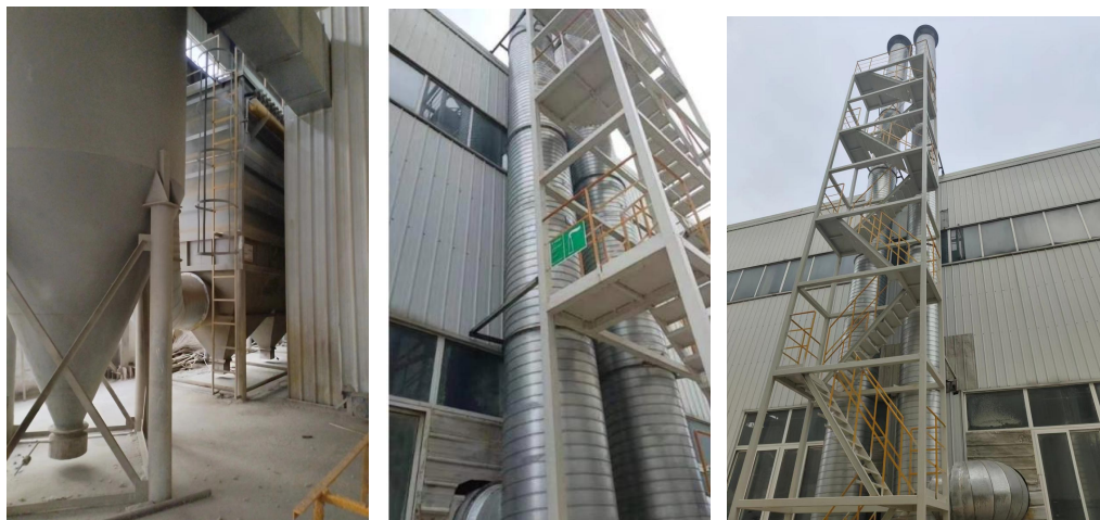
老厂房打磨废气密闭收集+布袋除尘器装置+DA001 排气筒
