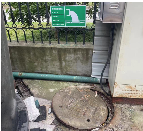
图 3-1 厂区污水接管口
