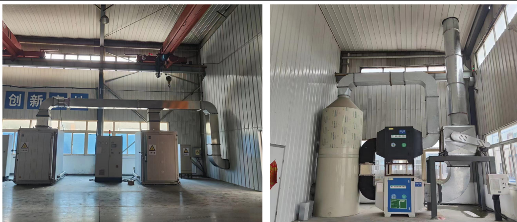
有机废气收集管道装置+冷却塔+二级活性炭装置+DA002 排气筒
