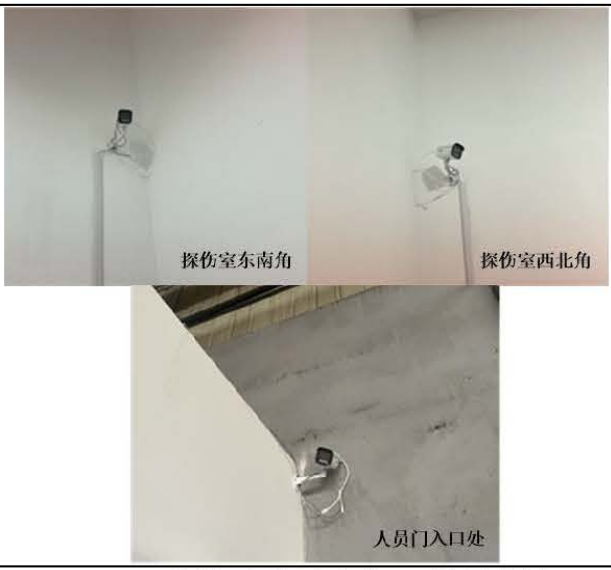
(9-1) 探伤室内及出入口视频监控
