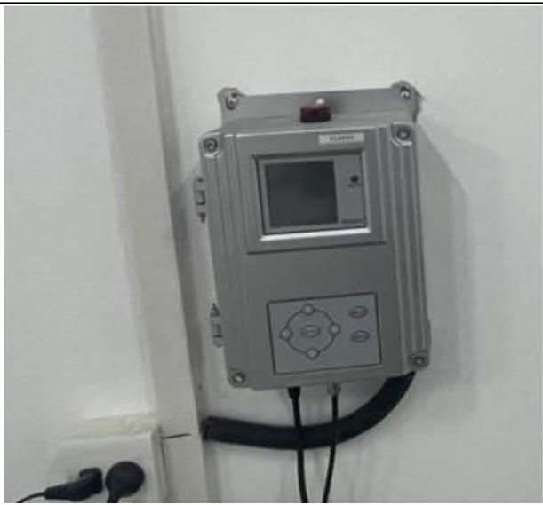
操作台处监控报警装置显示仪器
