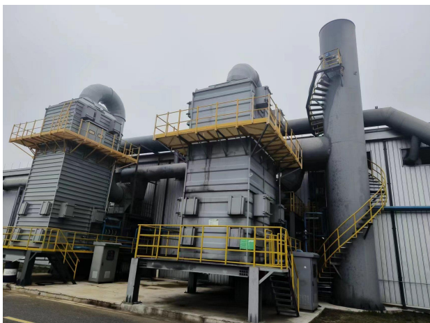
DA007 排气筒及处理设施
