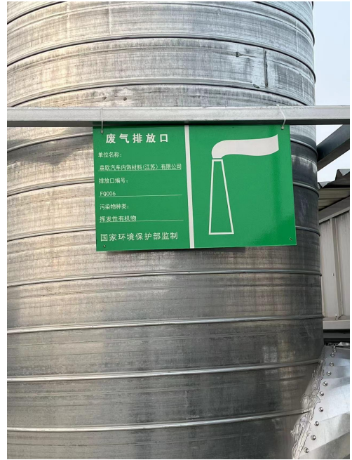
DA006 排气筒标识牌
