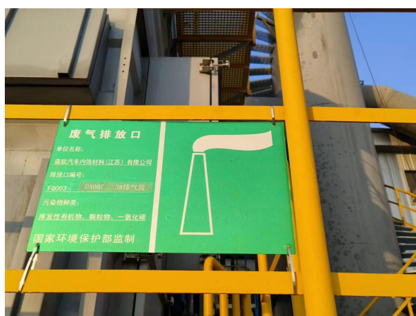
DA007 排气筒标识牌
