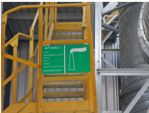
DA005 排气筒标识牌
