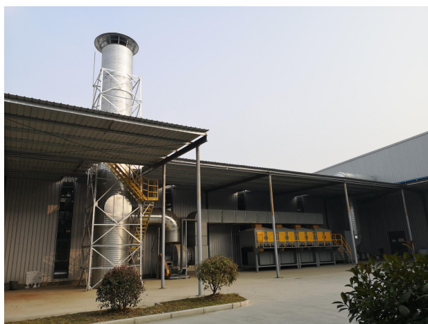
DA008 排气筒及处理设施
