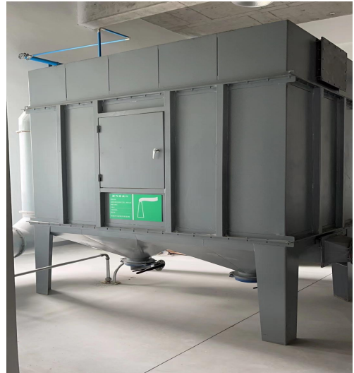
DA001 排气筒处理设施
