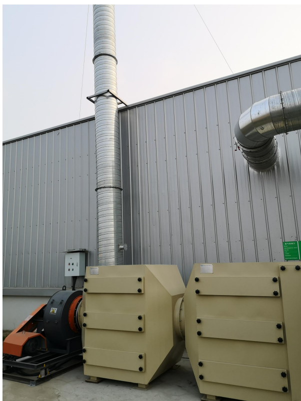
DA003 排气筒处理装置
