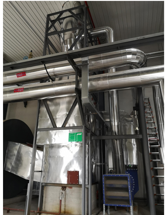
DA004 排气筒处理设施
