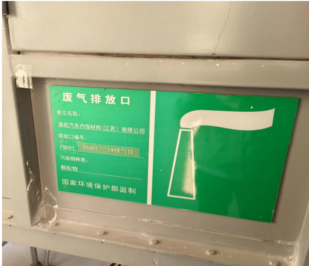
DA001 排气筒标识牌
