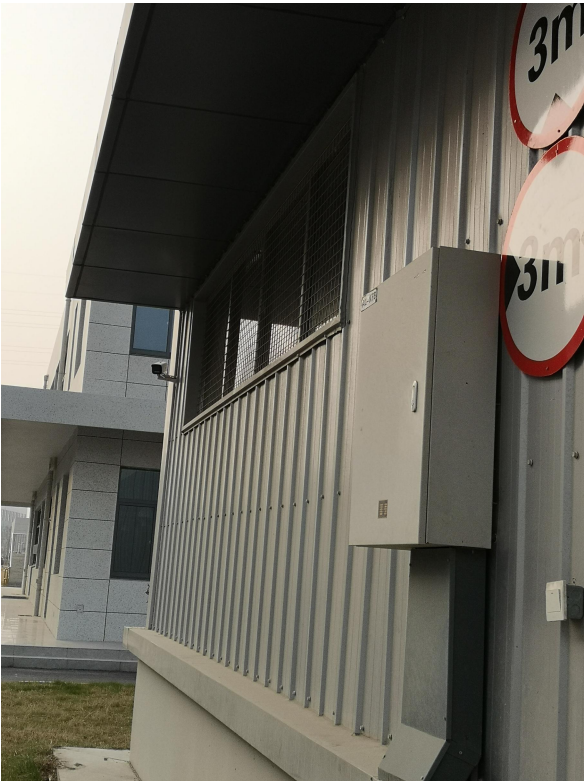
危废库门口监控
