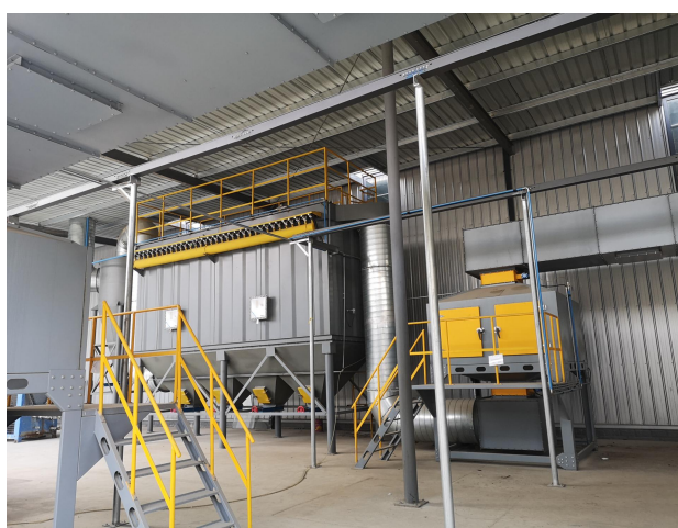
DA005 排气筒处理设施
