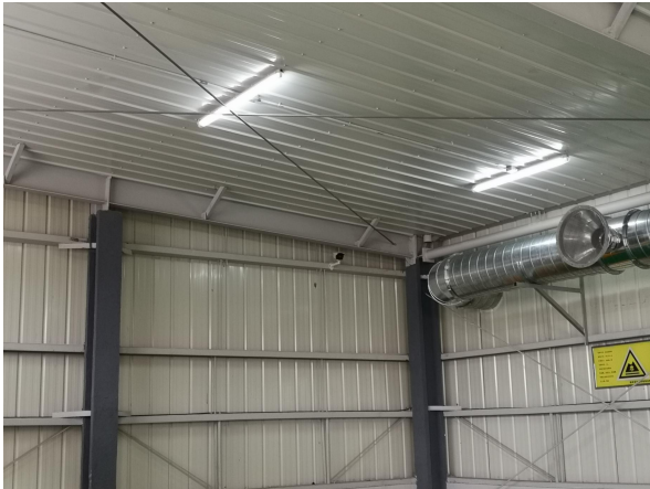
危废库内部监控
