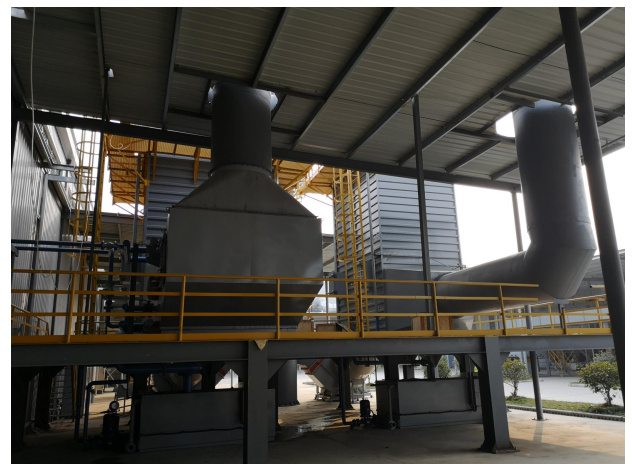
DA002 排气筒及处理设施
