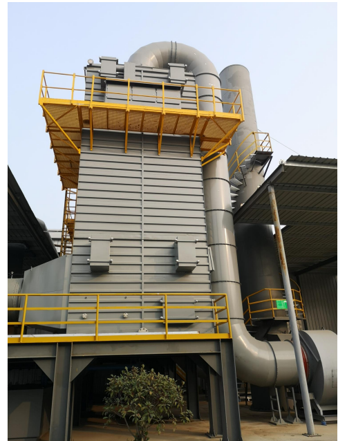
DA002 排气筒及处理设施
