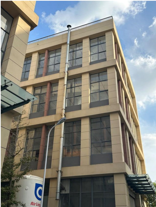
图 3-3 废气处理装置及排气筒
