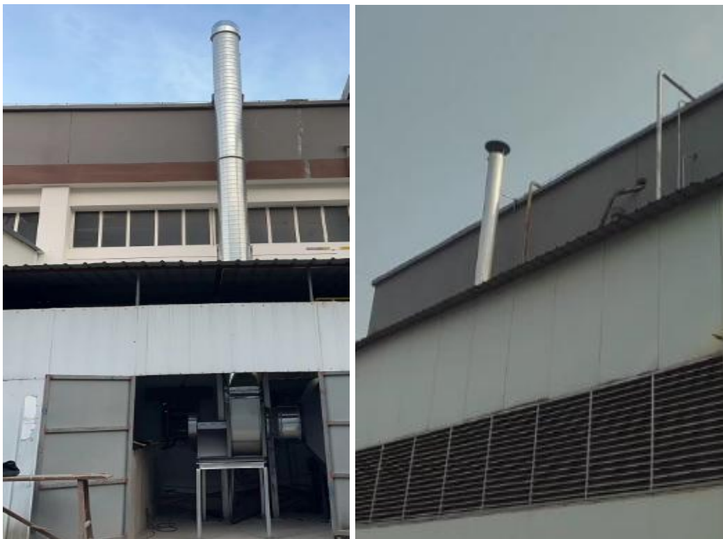
有机废气排气筒 DA001
