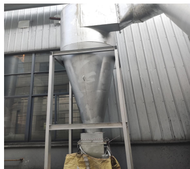
1#排气筒旋风除尘装置
