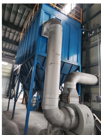
3#排气筒布袋除尘装置
