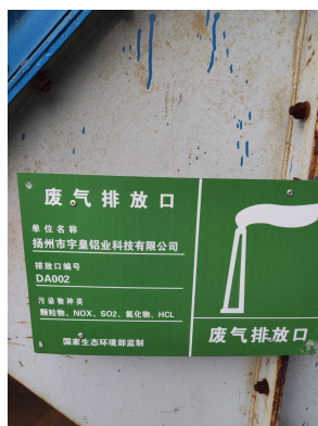
2#排气筒标识牌
