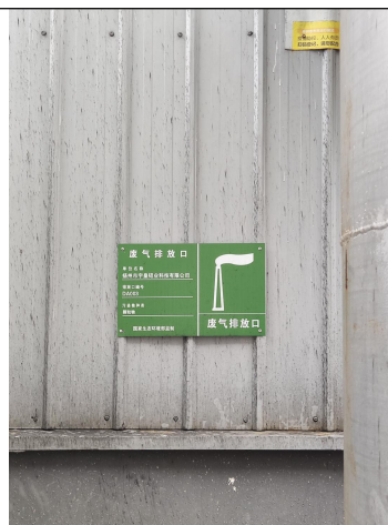
3#排气筒标识牌
