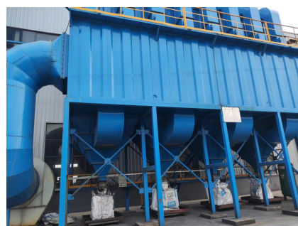
2#排气筒 1#布袋除尘装置
