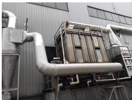
1#排气筒静电除尘装置
