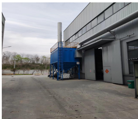
1#排气筒布袋除尘装置
