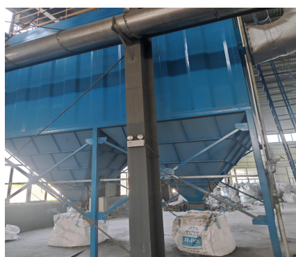
2#排气筒 2#布袋除尘装置
