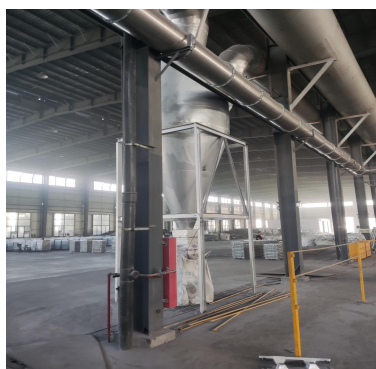
2#排气筒旋风除尘装置
