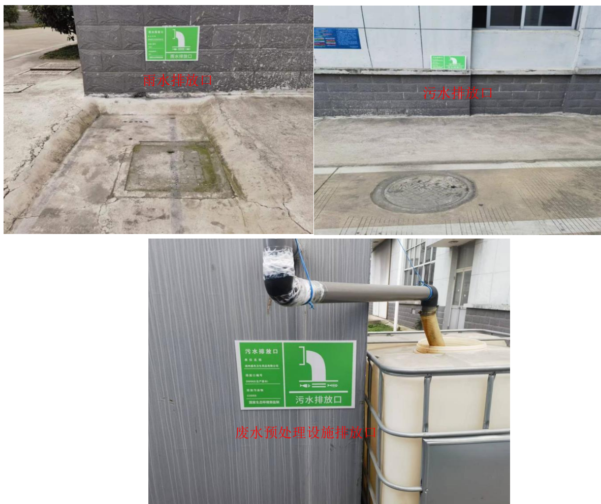
图3-3 雨污水排放口及环保标识牌
