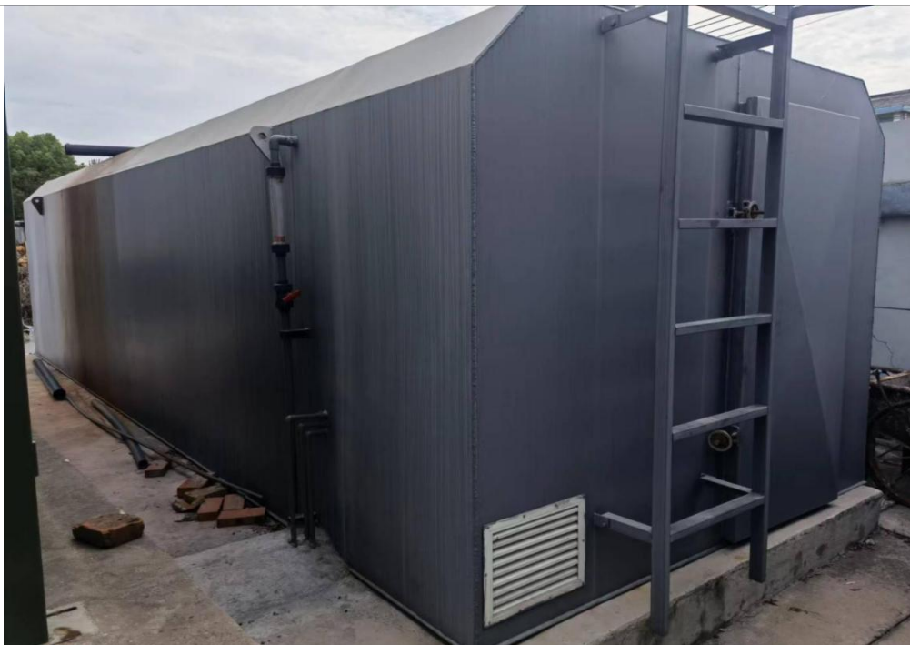
图3-2 废水预处理装置
