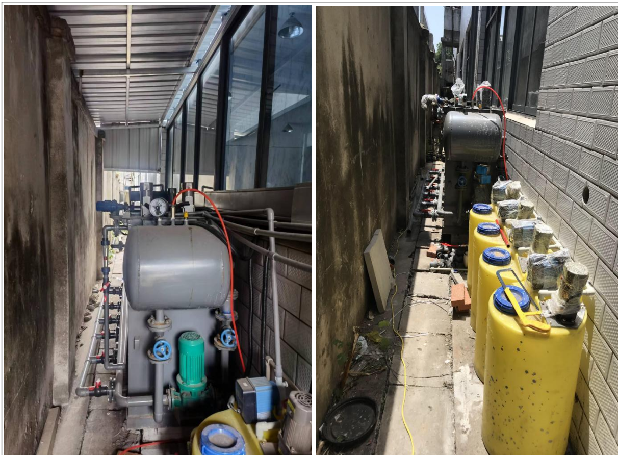
图3-2 清洗废水处理设施
