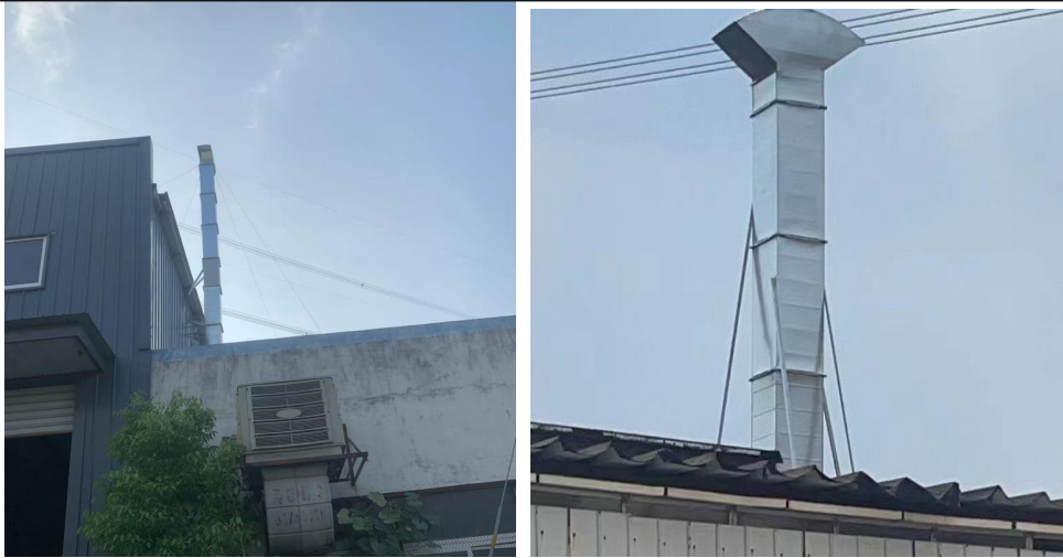
图 3-5 废气排气筒照片
