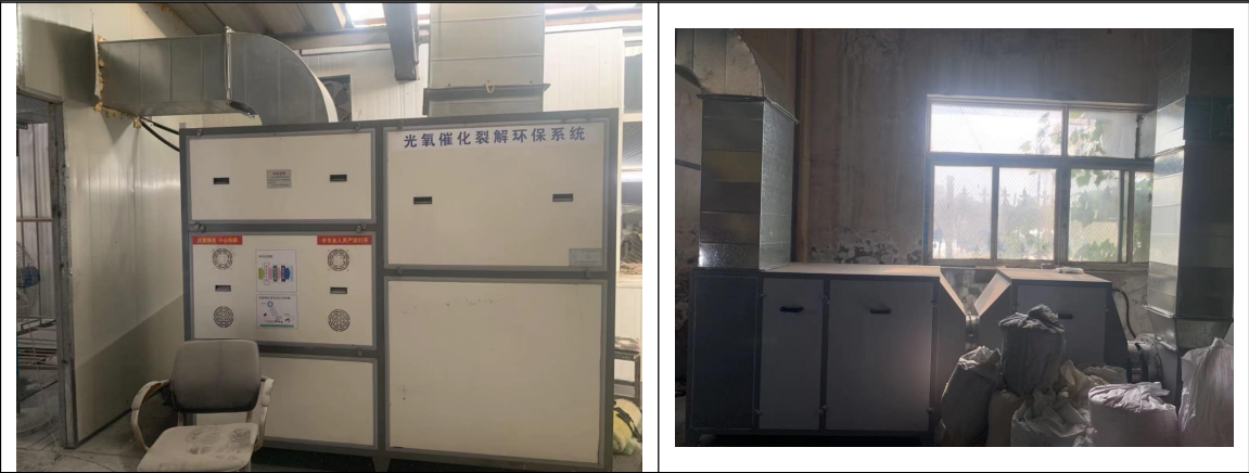
图 3-4 现场废气处理设施照片
