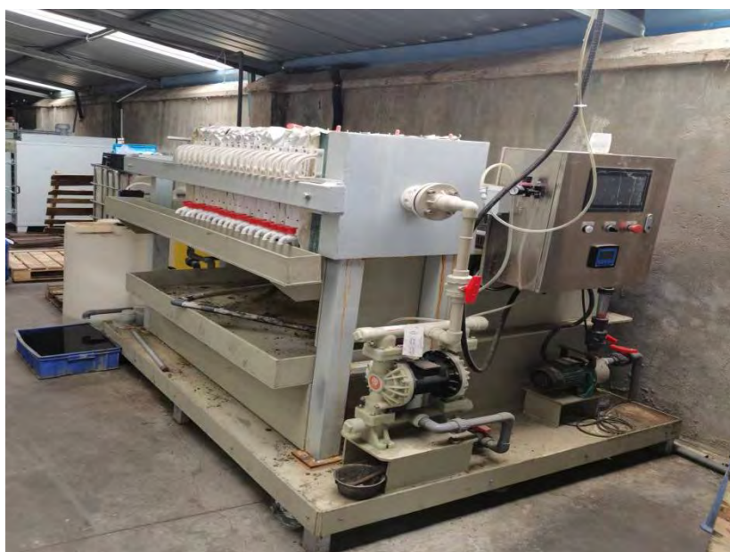
图 3-1 厂区内污水处理系统
