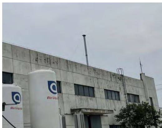
燃烧废气排气筒
