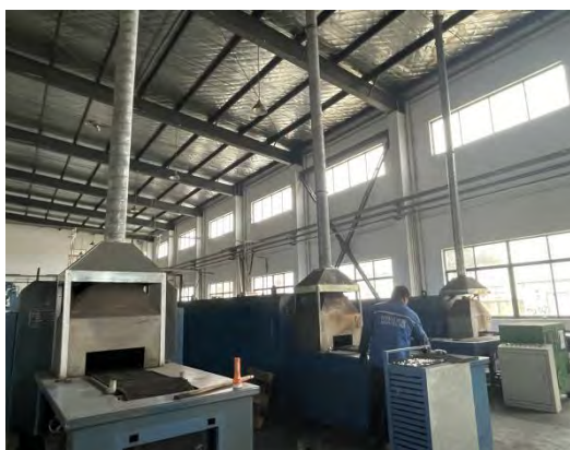
网带烧结炉燃烧装置
