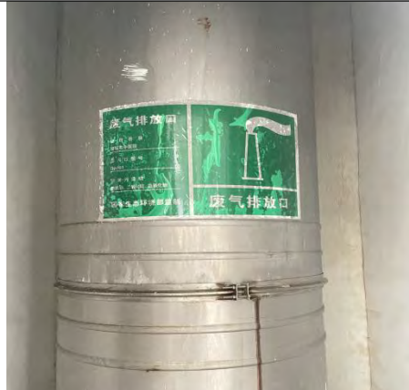
图 4-8 1#排气筒（燃气废气）
