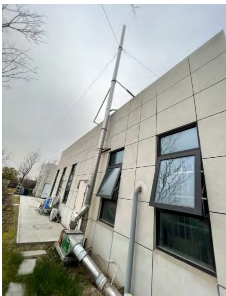
图 4-11 污水处理站废气处理设施
