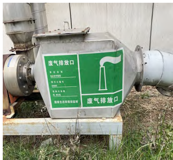
图 4-12 3#排气筒排放口（污水处理站废气）
