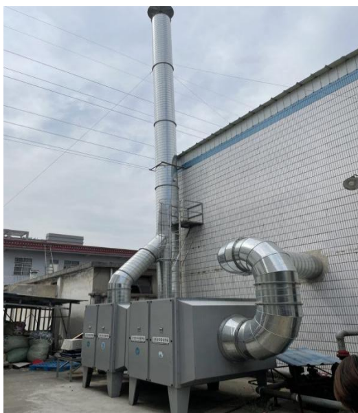
图 3-3 二级活性炭装置+排气筒
