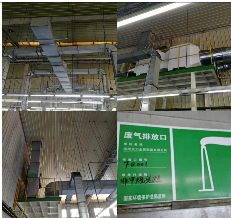
图 3-5 过滤棉净化装置及排气筒标识标牌
