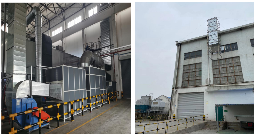
图3-5 废气处理装置及排气筒
