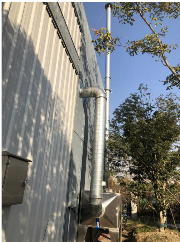
图 5 危废库排气筒
