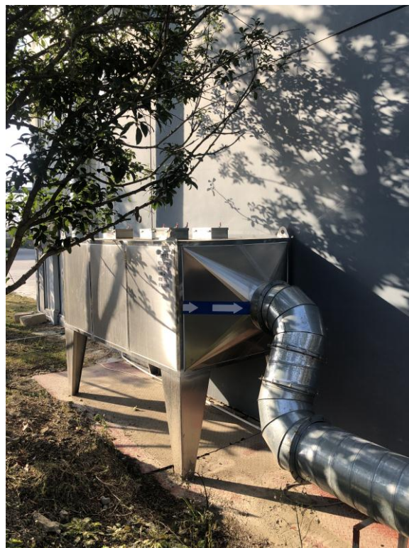
图 6 危废库治理设施
