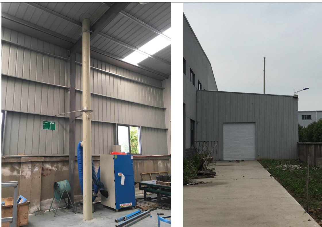
图 3-5 焊烟净化器及排气筒
