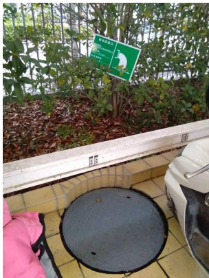
图 3-3 雨水排放口标识牌
