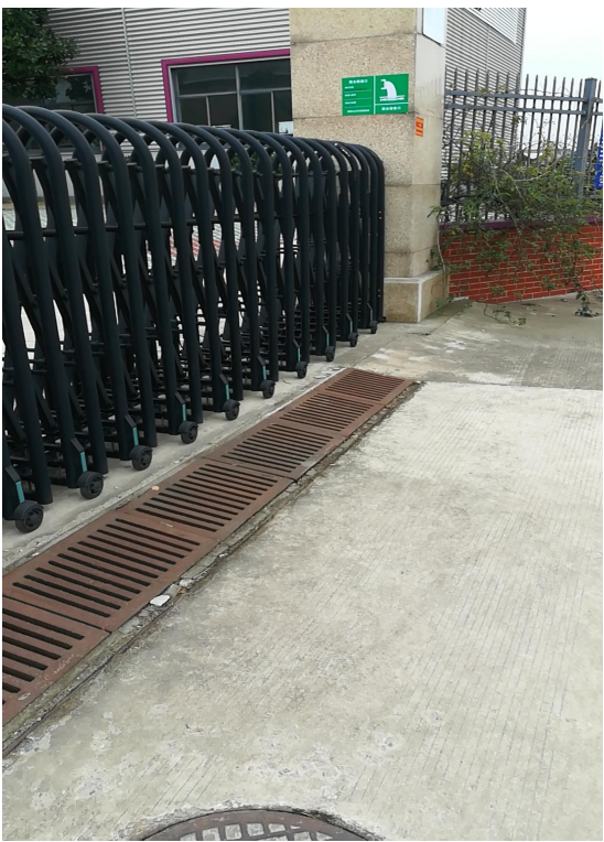
图 4-4 厂区雨水排口及环保标识牌
