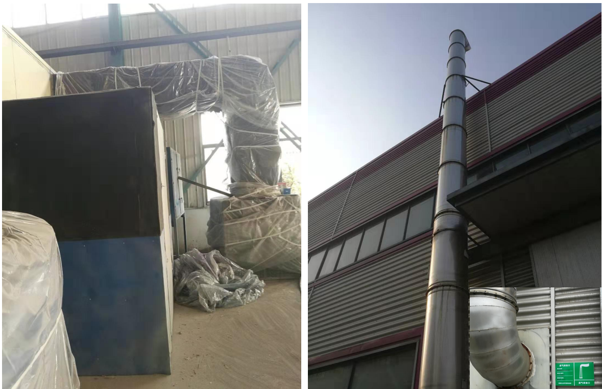
图4-7 喷漆废气处理装置及排气筒标识
