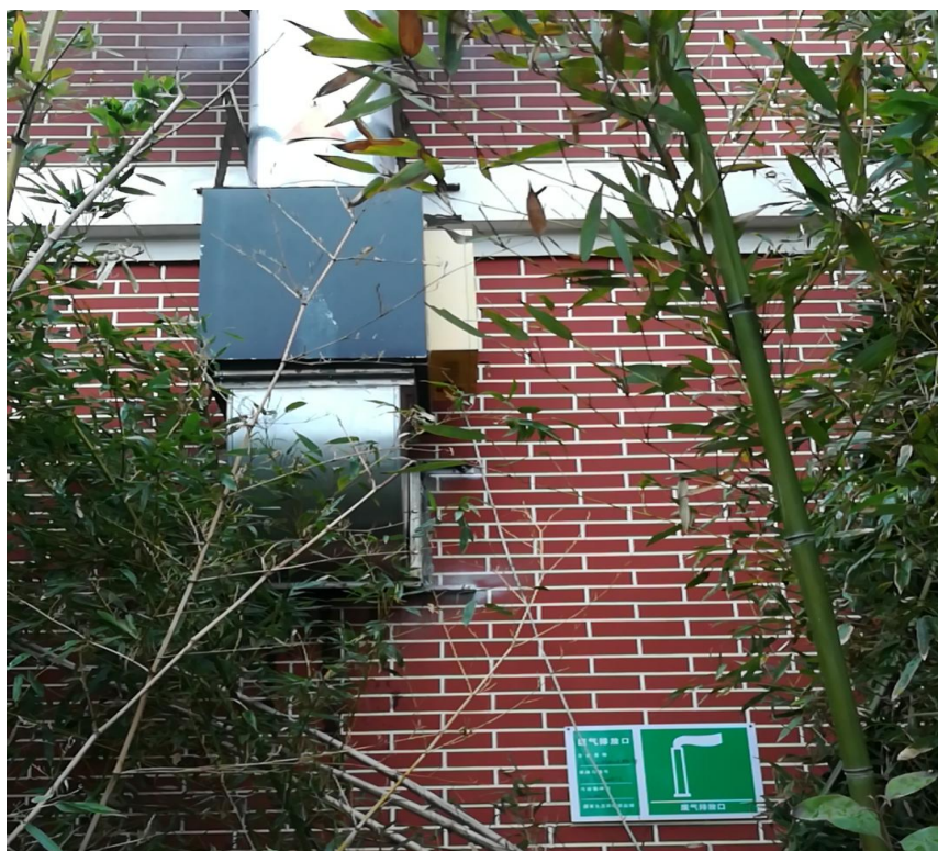
图4-8 油烟废气处理装置及排气筒标识
