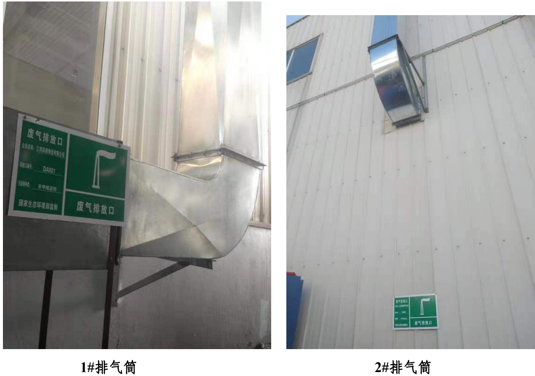
图 3-5 废气污染防治装置
