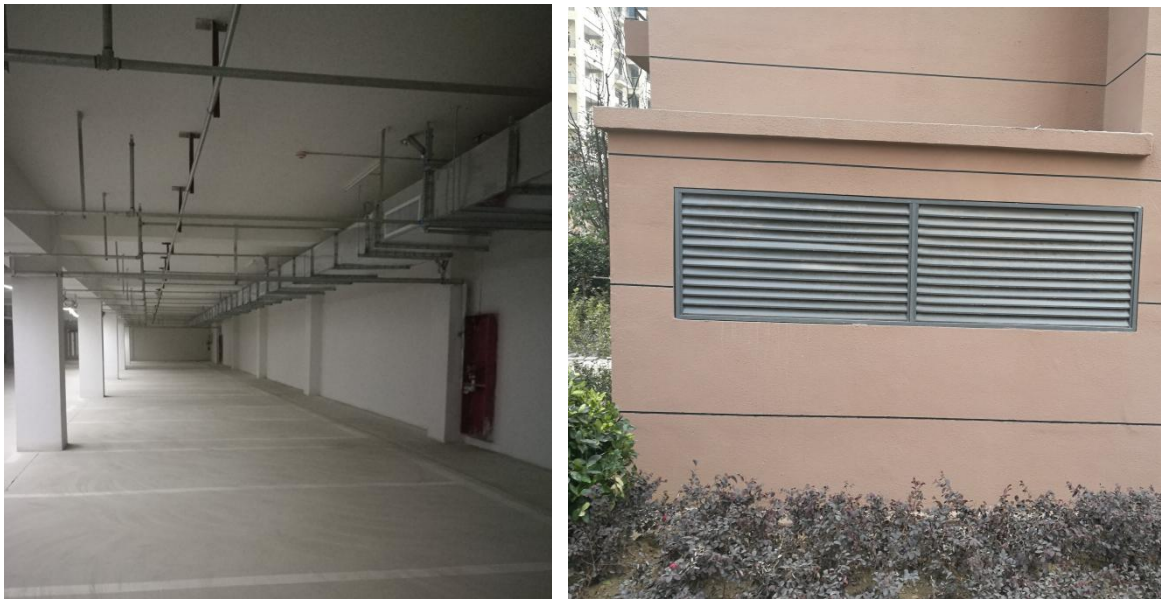
图 3-6 地下车库排风系统及排风口
