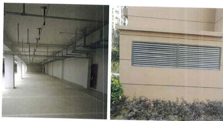
图 3-6 地下车库排风系统及排风口
