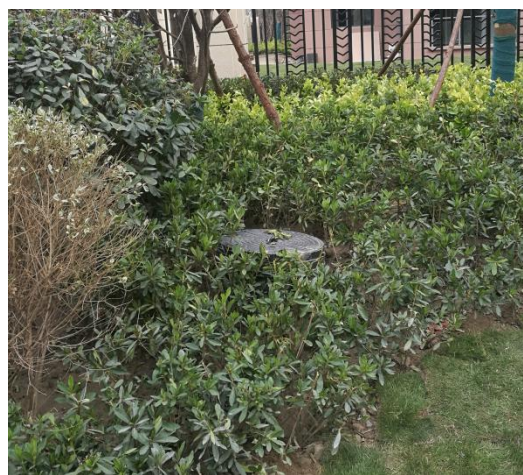
图 3-4 A 区废水接出口位置
