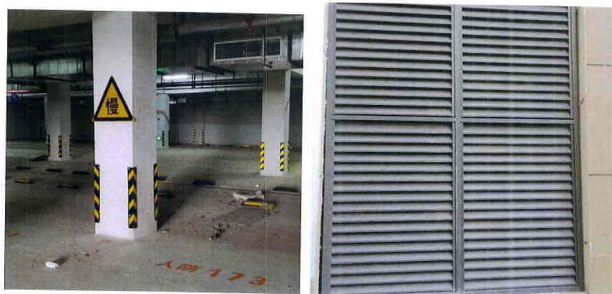
图 3-6 地下车库排风系统及排风口
