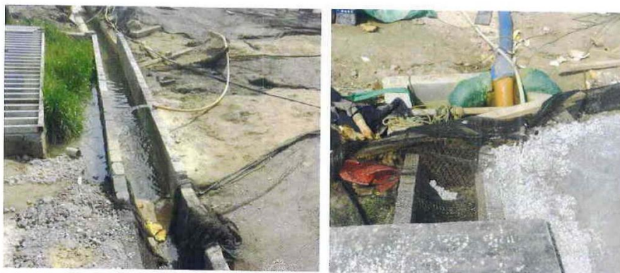
图 3-1 施工期废水收集图
