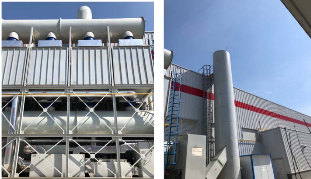
图 4.2-3 废气处理装置现场照片
