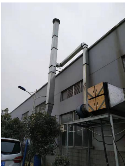
图 3-1 固化车间排气筒
