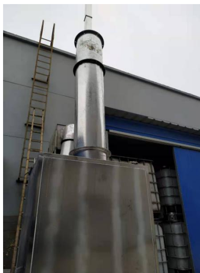
图 3-2 配料车间排气筒
