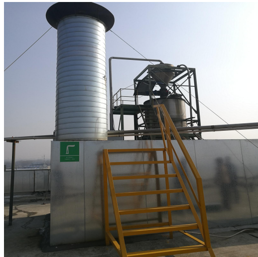
图 10-2 布袋除尘排气筒
