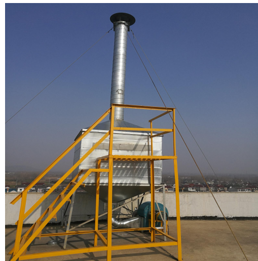
图 10-4 煅烧废气净化装置
