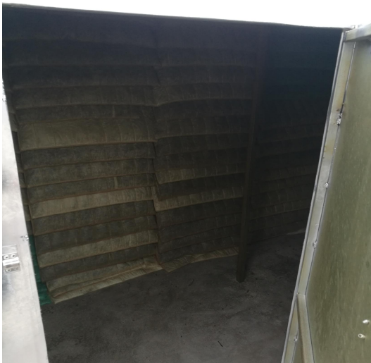
图 10-3 布袋除尘装置
